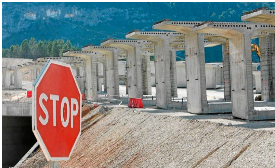
Las obras de la autovía central a su paso por Alcoy en el año 2009. | ERNESTO CAPARRÓS.
